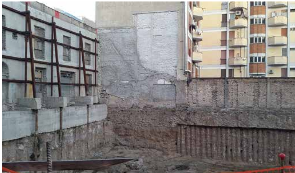
Fig.2 Vista della voragine nello scavo di Sabelli Trading, al posto delle Ex Fonderie Bastianelli in via dei Sabelli.
